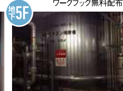
雨水貯留槽、バイオガス設備ほか
